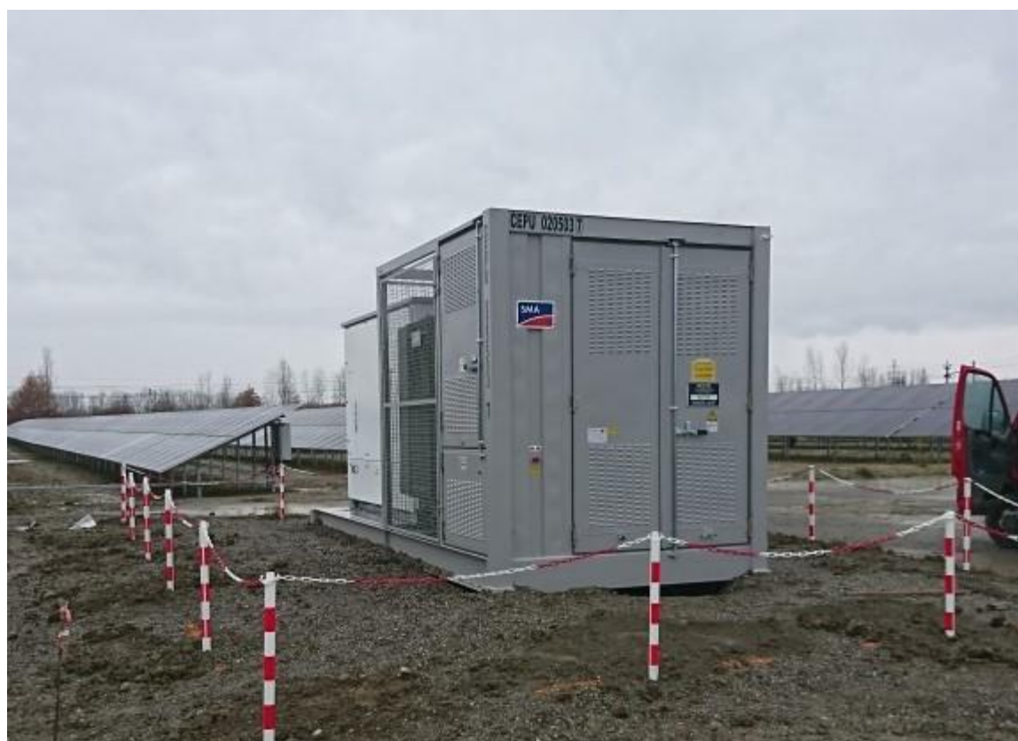
Figure 45 : Illustration d'un poste de transformation (source : VALOREM, 2021)
